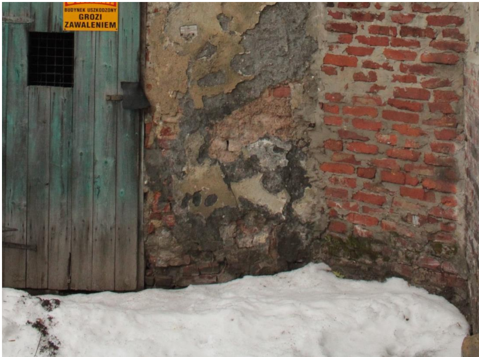
Zdjęcie przedstawia stan techniczny ścian na styku z gruntem
